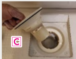
封水筒のつまみを持って回して封水筒を外します。やっぱり汚れています
