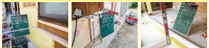
外張付加断熱GW/32k 厚50ミリ ネオマフォーム/厚25ミリ 床断熱GW/厚150ミリ
