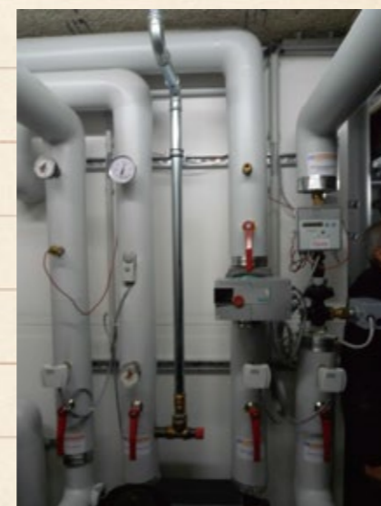
↑配管の裏はペレットのサイロ
