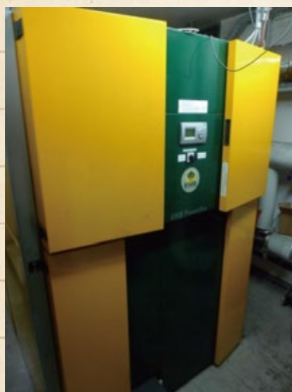
↑ペレットボイラー
